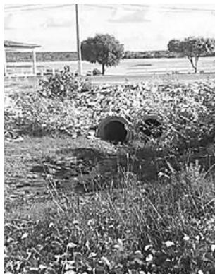
Figura 6 - Esgoto na Lagoa
