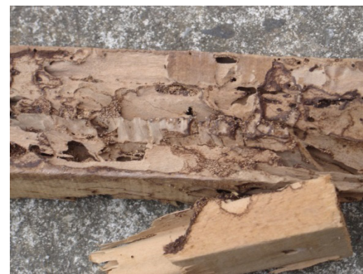
Figura 5.3. Amostra de madeira atacada por cupins subterrâneos. Fonte: Autoria própria (2016)
