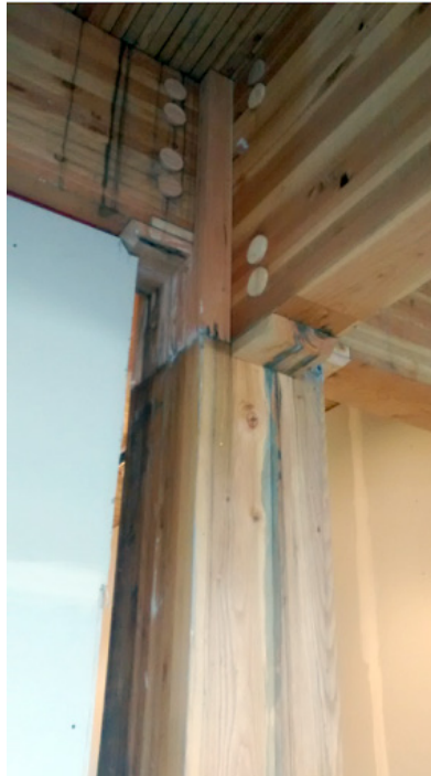
Figura 2.4. Uso estrutural de peças de madeira atacada por fungos manchadores
