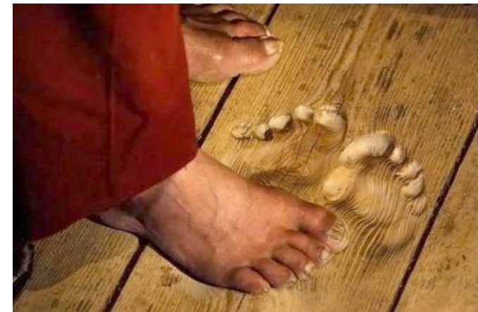
Figura 1.1. Desgaste mecânico no piso de madeira do templo Tongren, China.
