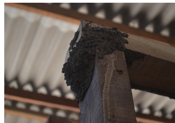
Figura 5.4. Ninho de cupins subterrâneos formado em estrutura de madeira úmida
