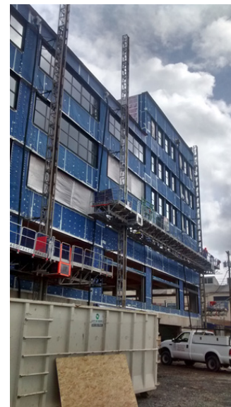
Figura 12.4: Vista exterior de um edifício em construção de 6 andares sendo 5 deles de madeira, desenvolvido pela Killian Pacific em Vancouver, Estados Unidos.
