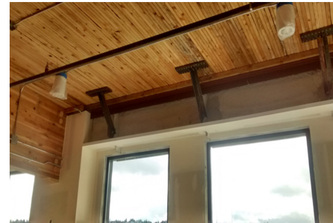
Figura 12.1: Edifício desenvolvido pela Killian Pacific em Vancouver-WA (Estados Unidos) com presença de fungos manchadores no forro do teto. Fonte: A autoria própria (2016)
